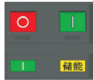
断路器合闸且已储能完毕状态
