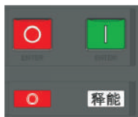
断路器断开且无储能状态
