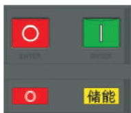
断路器断开且已储能完毕状态
